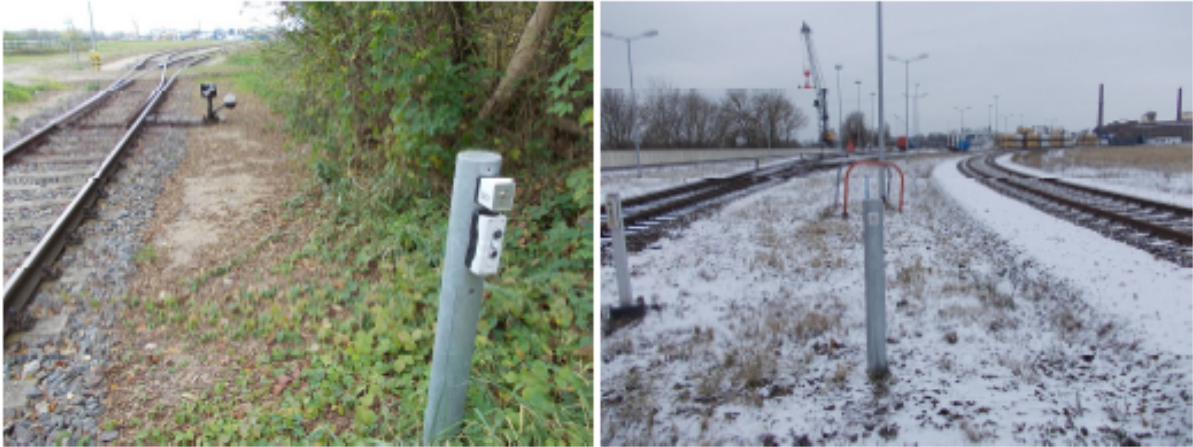
Abbildung 1: Schlüsselschalter 1 + 2 (links + rechts); ST 1 kombiniert mit Schalter für Beleuchtung
